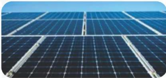
500KW P.P.A. SOLAR CHAMBA HIMACHAL
